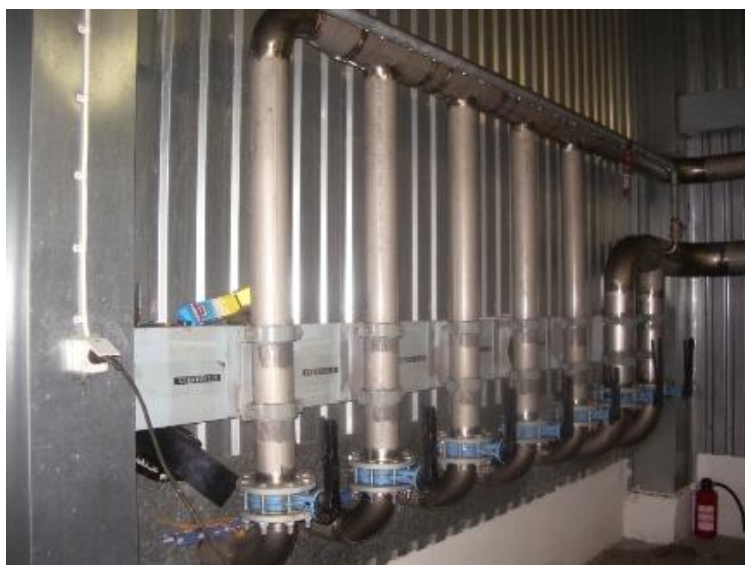
Рисунок 4.2.3.1 - Вид системы подачи воды из скважин в помещении ВОС
