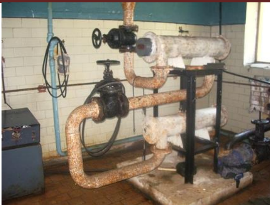
Рисунок 4.2.3.9 - Состояние блока УФ обеззараживания
